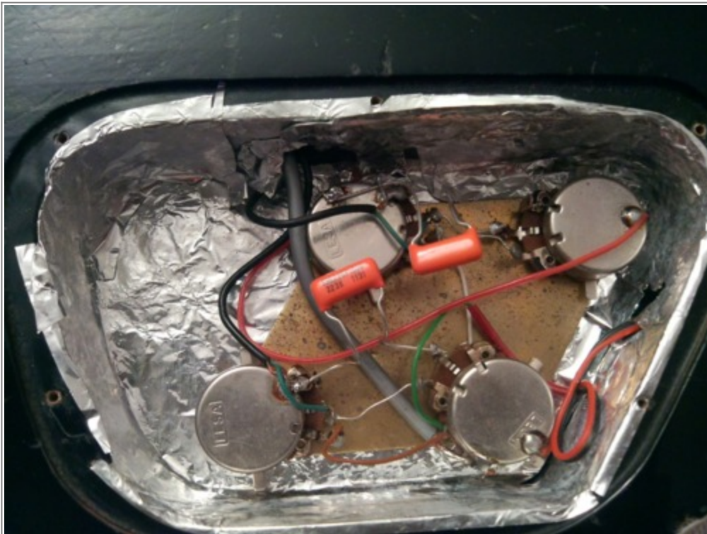
Les nouveaux condensateurs installés.
